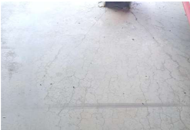
Risse beginnen sich in der Epoxidschicht zu bilden
