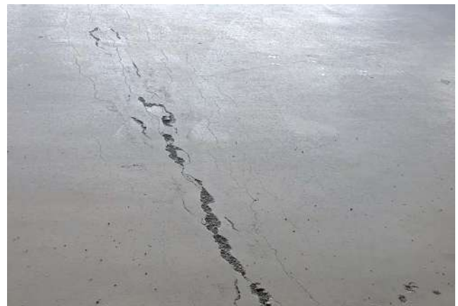
Nach geraumer Zeit entstehen große sichtbare Schäden
