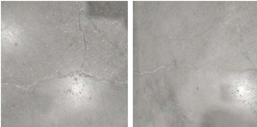
Risse nach 14 Jahren.
