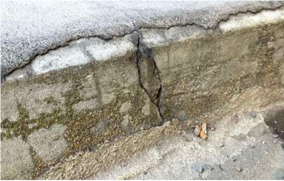
Übliche sichtbare Schäden - so fangen die Probleme an.
